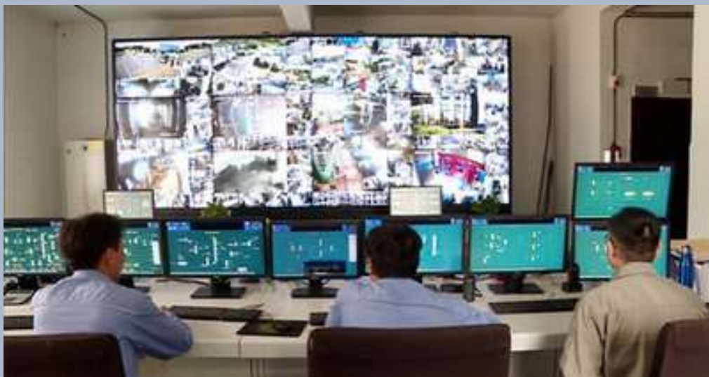
传统智能化监控室机房
