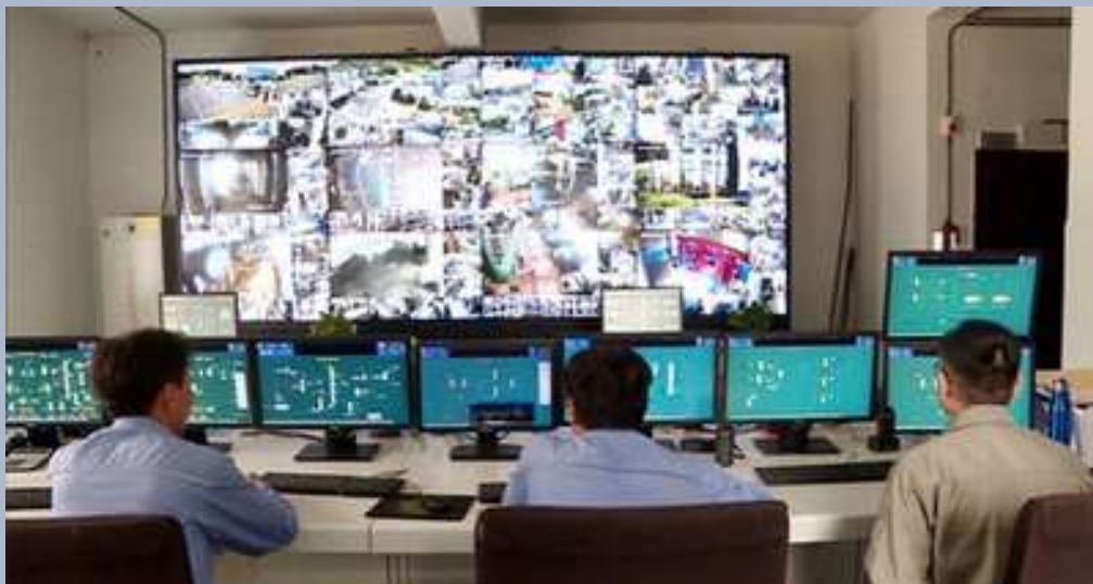
传统智能化监控室
